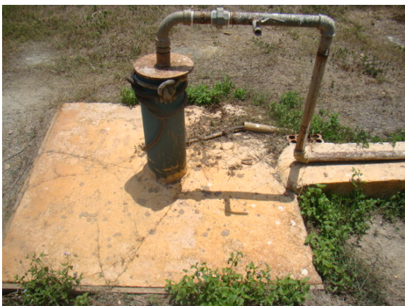
Foto 84/01 - Detalhe do poço tubular profundo PTP 07
