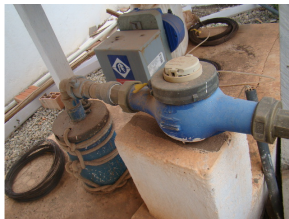
Foto 84/10 - Detalhe poço tubular profundo
