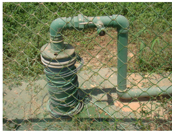
Foto 84/02 - Detalhe do poço tubular profundo PTP 08
