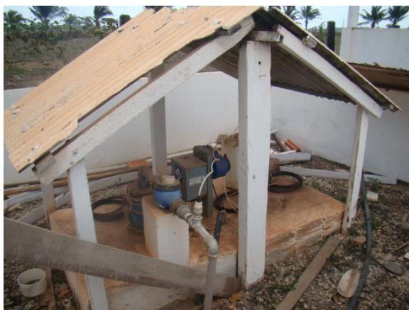
Foto 84/09 - Poço tubular profundo PTP 09
