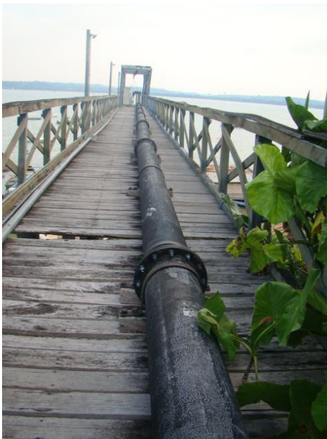
Foto 01/03 – Tubulação da água
