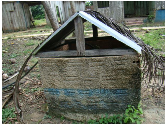
Foto 06/01 – Cobertura do poço tubular profundo (PTP01) na nucleação São Leopoldo do Tapajós (km 180)
