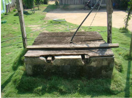
Foto 39/03 – Cacimba com 15m de profundidade na moradia de Dona Lurdes
