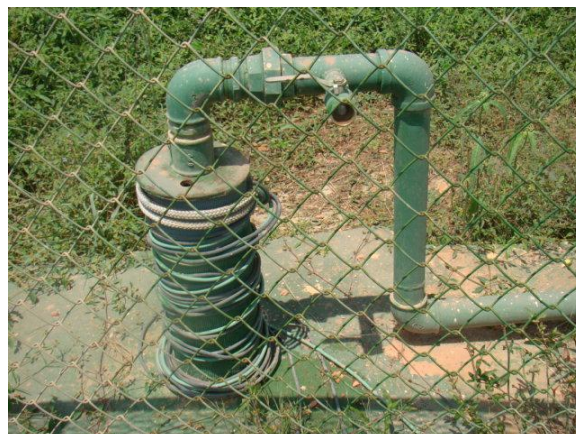
Foto 02/21 - PTP08 – detalhe do poço tubular profundo no Frigorífico Frivata
