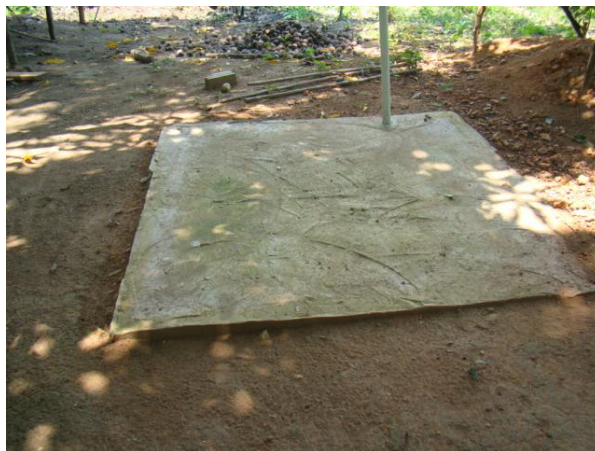
Foto 25/25 – Fossa séptica na residência do Sr. Washington Luiz.
