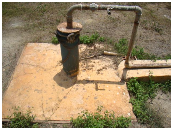
Foto 02/20 – PTP07 detalhe do poço tubular profundo no Frigorífico Frivata
