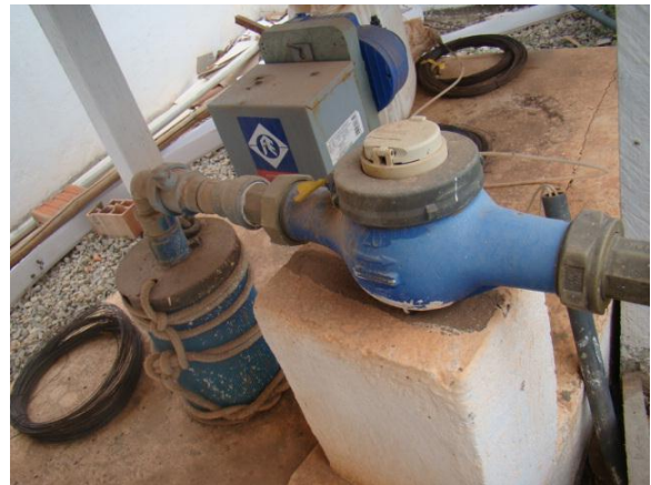
Foto 02/29 – Detalhe poço tubular profundo no frigorífico Friara
