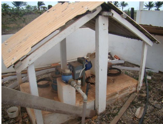
Foto 02/28 – PTP09 poço tubular profundo no frigorífico Friara
