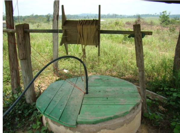
Foto 06/06 – Detalhe do Poço tubular raso (PTR01)
