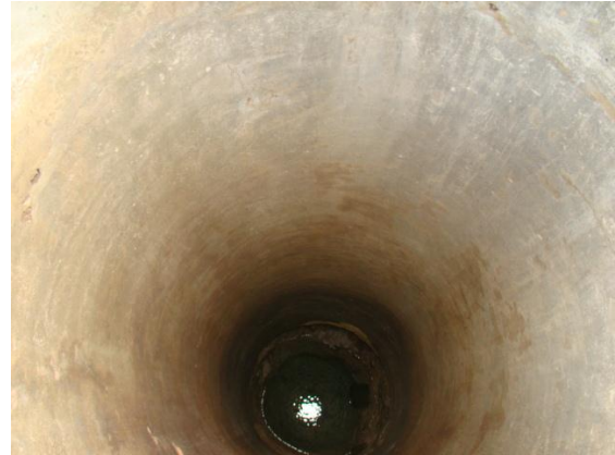
Foto 24/06 – Detalhe da lâmina d'água da cacimba.
