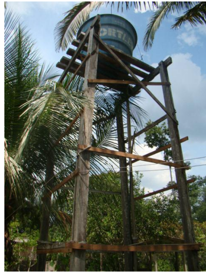
Foto 25/41 – Caixa d'água da residência do Sr. Remi José Damasceno
