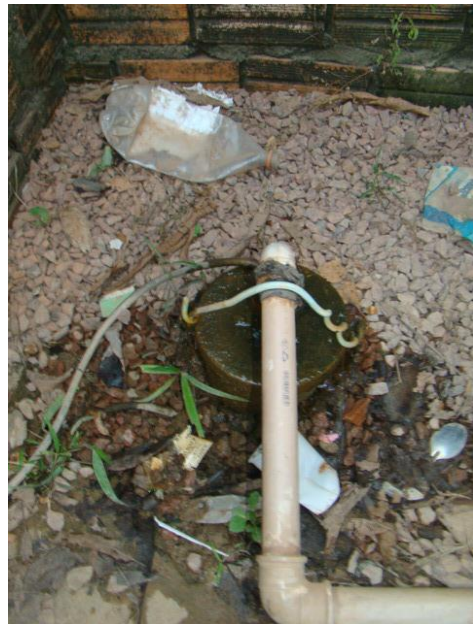
Foto 34/03 – Detalhe do poço tubular profundo da Escola Everaldo Martins
