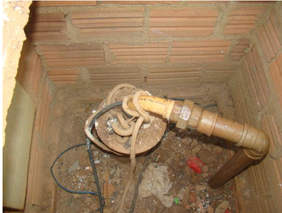
Foto 34/01 - Poço tubular profundo no posto de combustível Dado.
