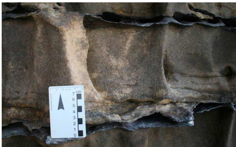
Foto 04: Detalhe das crostas ferruginosas (recentes), preferencialmente nos planos de descontinuidade da rocha.
