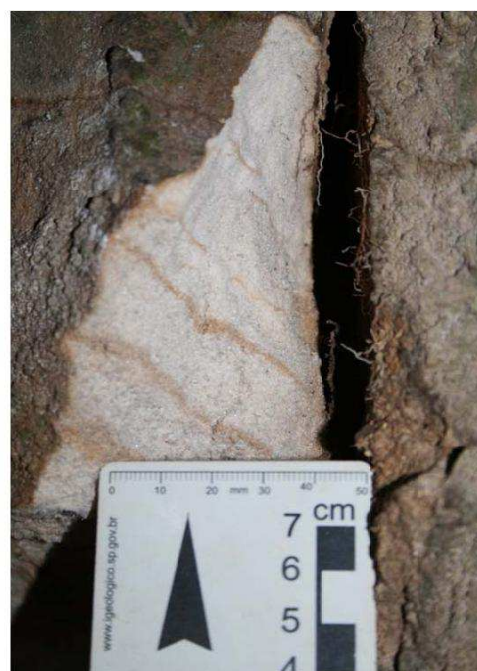
Foto 09: Detalhe da abertura milimétrica dos planos de fratura na Gruta dos Padres.
