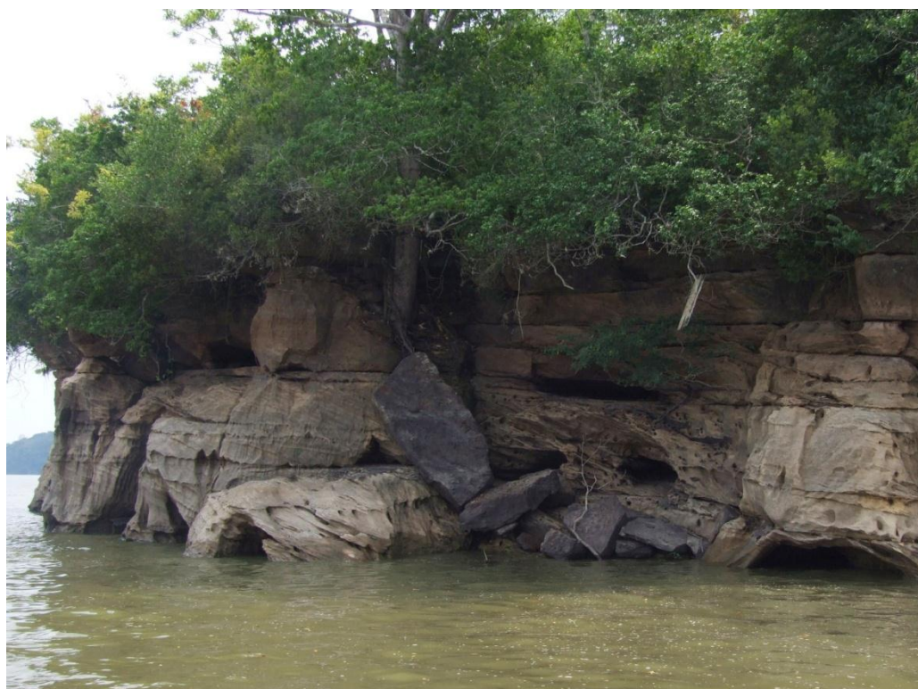
Foto 7.4.1.10/30 – Superfícies polidas e sulcos formados por abrasão e processos de cavitação causados pela formação de vórtices de eixos verticais ou horizontais associado a fluxo turbulento, em margem constituída por arenitos médios a grossos com estratificação cruzada, da Formação Maecuru (Coordenadas UTM 0580418 x 9509894).
