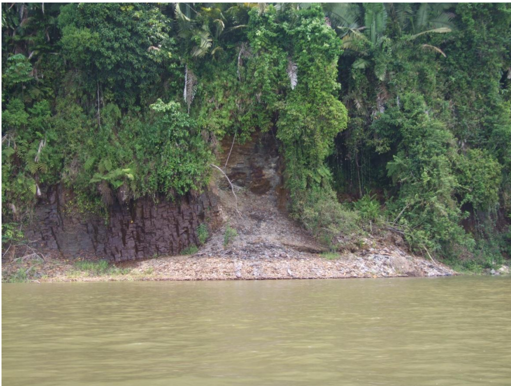
Foto 7.4.1.10/14 – Desmoronamento em margem constituída por folhelhos da Formação Monte Alegre (Coordenadas UTM 0594845 x 9515489).
