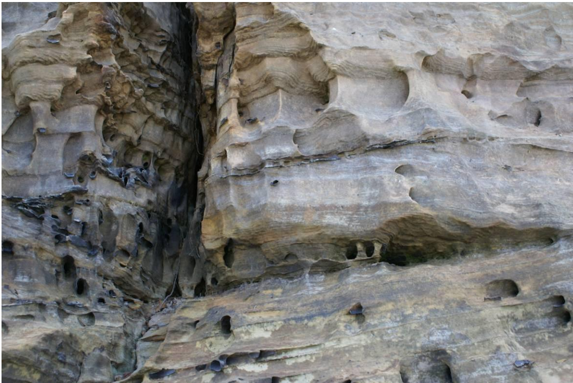
Foto 32 - Sistema de fraturas N60 - 70°W/V. Verificar os múltiplos planos subparalelos com desenvolvimento de crostas limonitizadas acompanhando os planos do faturamento e os níveis de acamamento / estratificação cruzada.
