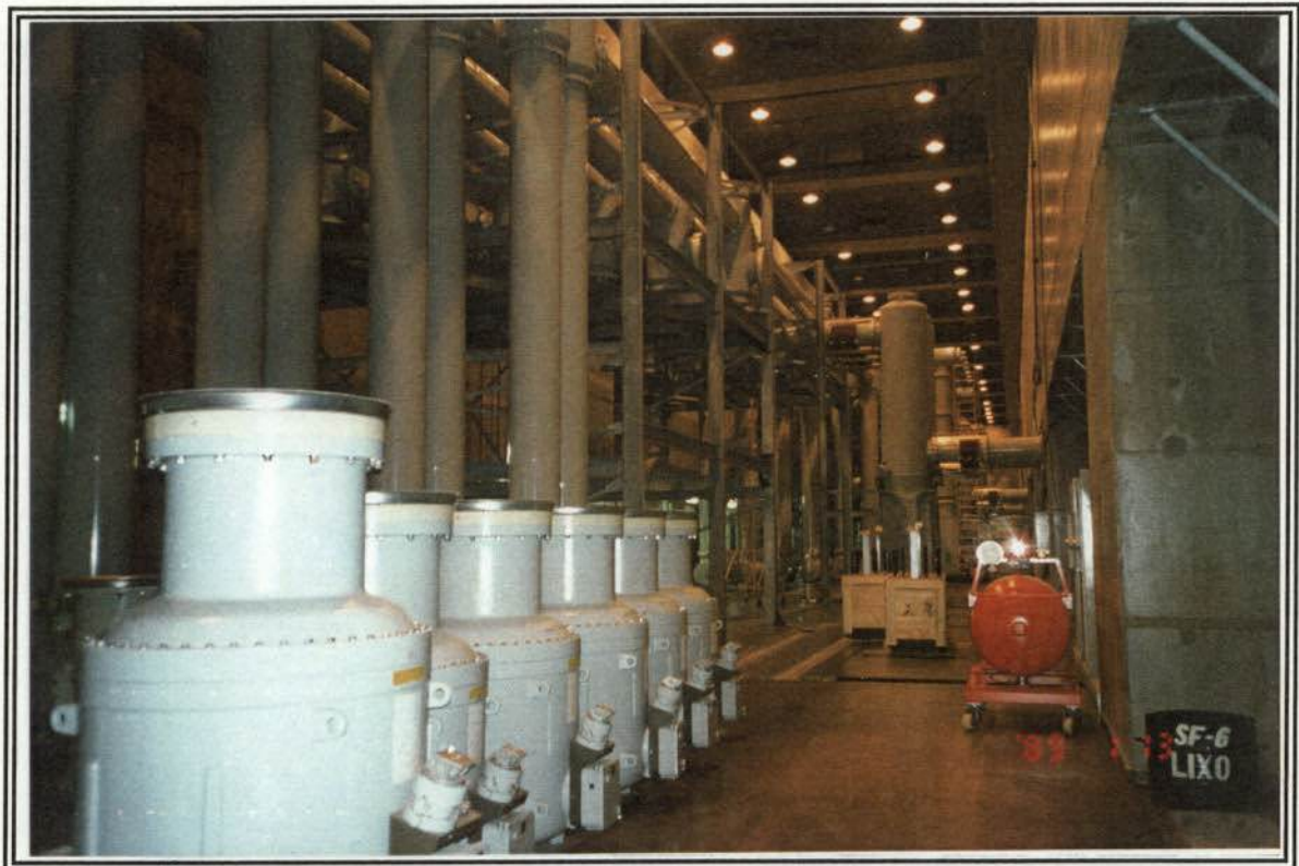
Foto 11. Detalhe da Subestação e da tubulação de refrigeração.
