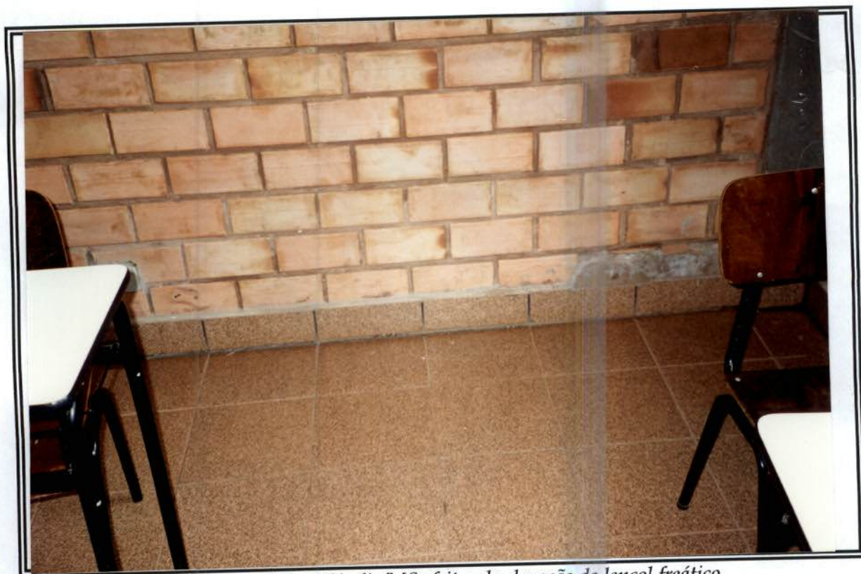
Monitoramento da escola em Anaurilândia/MS efeitos da elevação do lençol freático.
