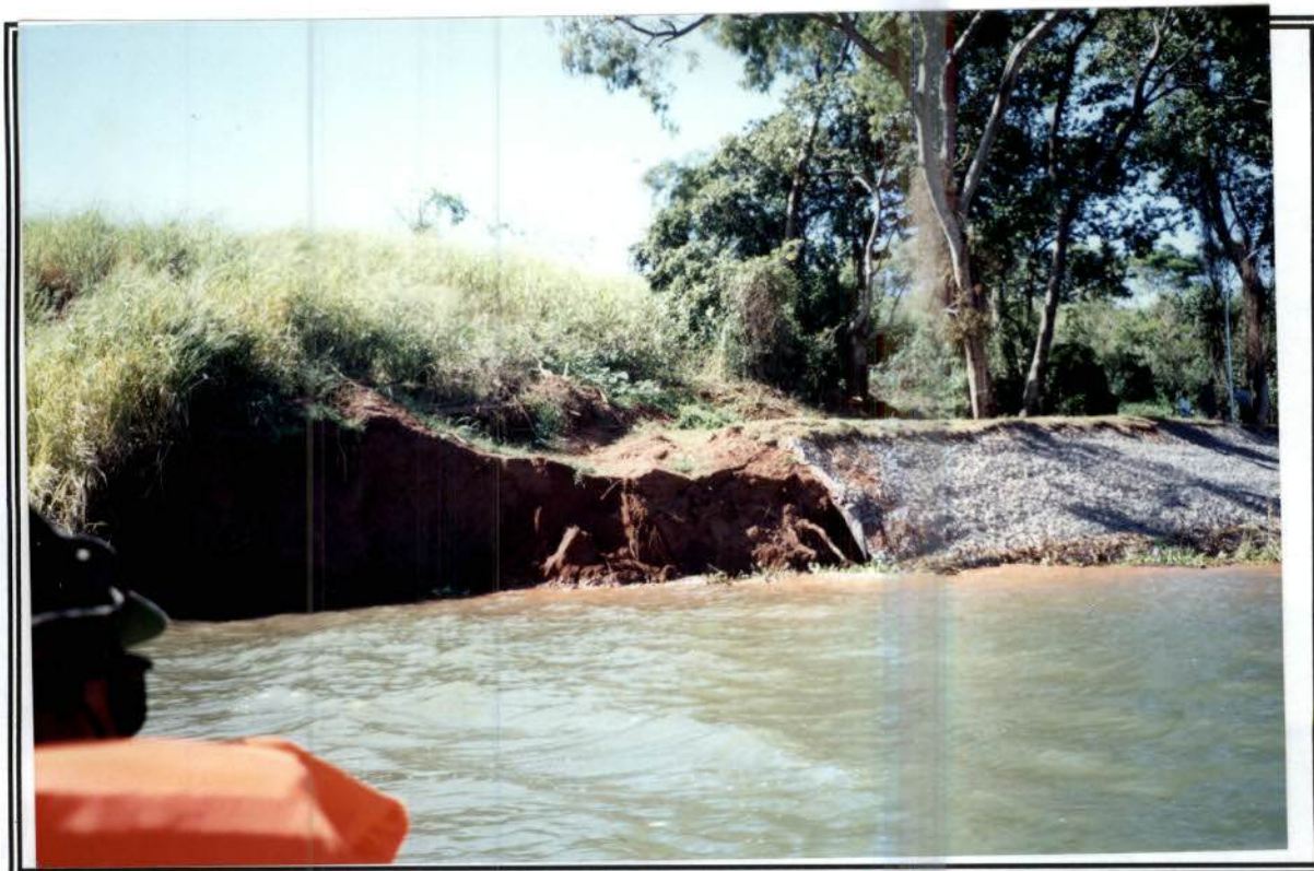
Contraste entre área protegida por manta de gabião e material não protegido.
