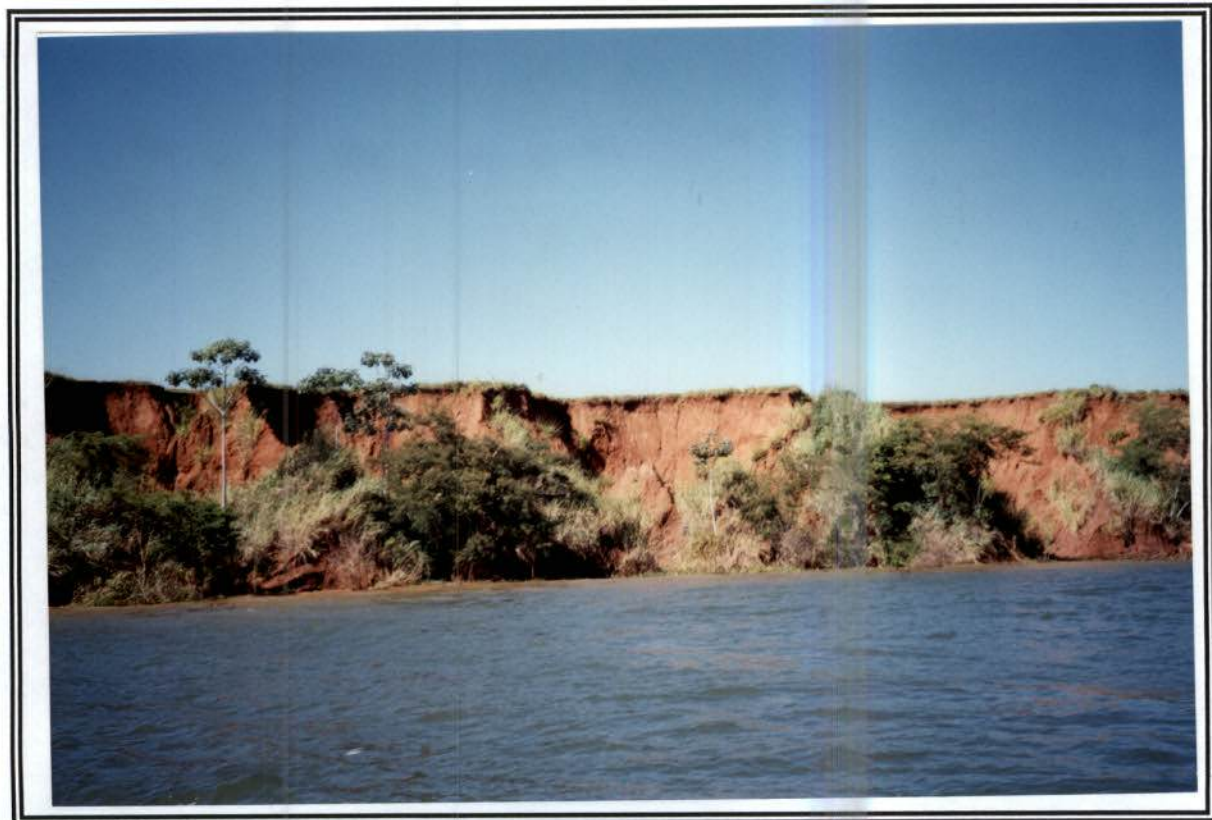
Erosão das margens com quedas de blocos de arenito e aumento do material erodido
