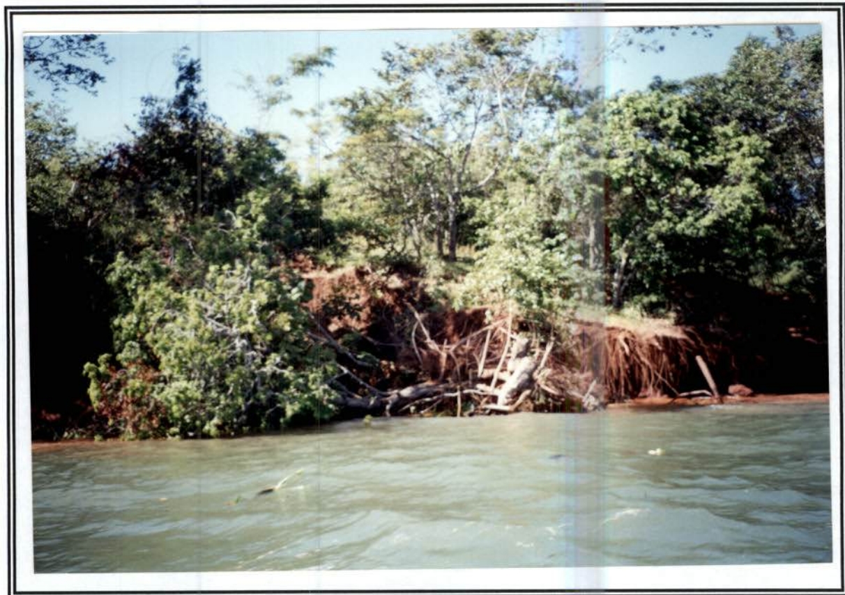
Erosão das encostas marginais realizada pelo embate de ondas no talude de arenito
