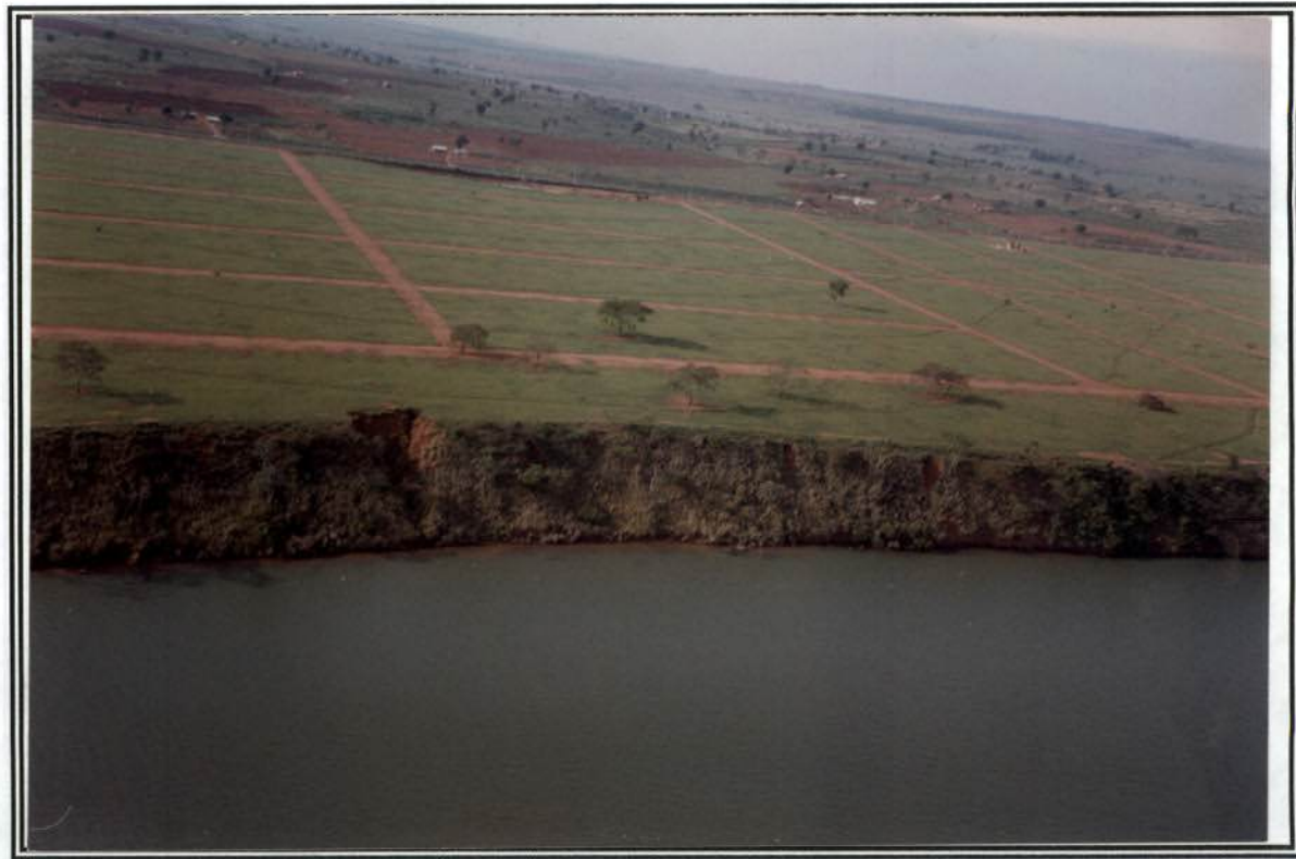
Foto 22 – detalhe do loteamento sendo implantado e processo erosivo na margem do lago.
