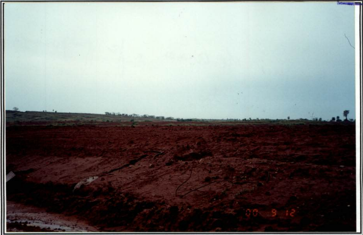
Foto 3 – reafeiçoamento da área de empréstimo – Margem esquerda, lado de São Paulo, explorada na construção da barragem.
