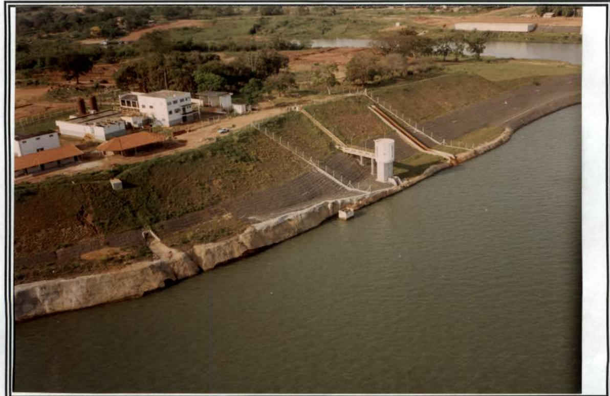
Foto 12 – tratamento das encostas, local de captação de água da SABESP, em Presidente Epitácio, detalhe de início de processo erosivo no talude ainda não totalmente revegetado.
