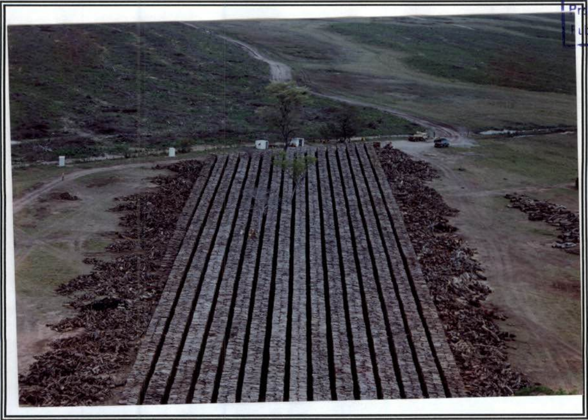
Retirada da de madeira já cortada, referente ao desmatamento, empilhamento fora da área de inundação
