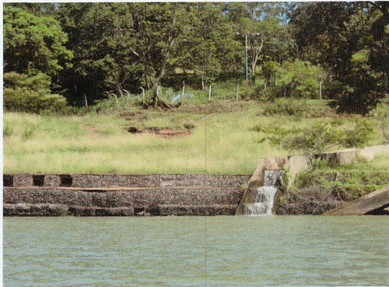
Foto 22 - Gabião protegendo área do Thermas, depreciação dos gabiões com a retirada das pedras (S 21° 44' 59.1'', W 52°05'47.2'')
