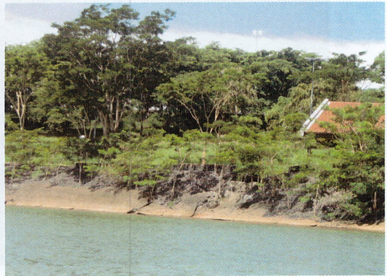
Foto 17 - Gabiões protegendo área do SESI, encosta sem direcionamento das águas pluviais (S 21° 46' 46.0", W 52°09'24.6")
