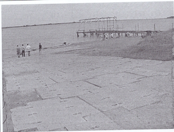
Ponto de embarque e desembarque pesqueiro urbano, não utilizado devido à necessidade de reforma da rampa de acesso
