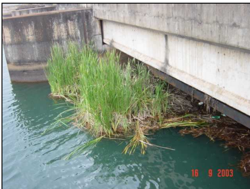
Foto 23 – Vista do aporte de macrófitas na tomada d'água da UHE Porto Colômbia (FONTE: MRS).
