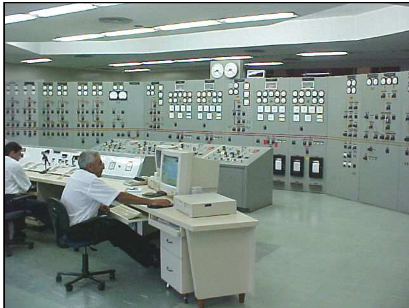
Foto 9 – Vista da sala de controle (FONTE: MRS).
