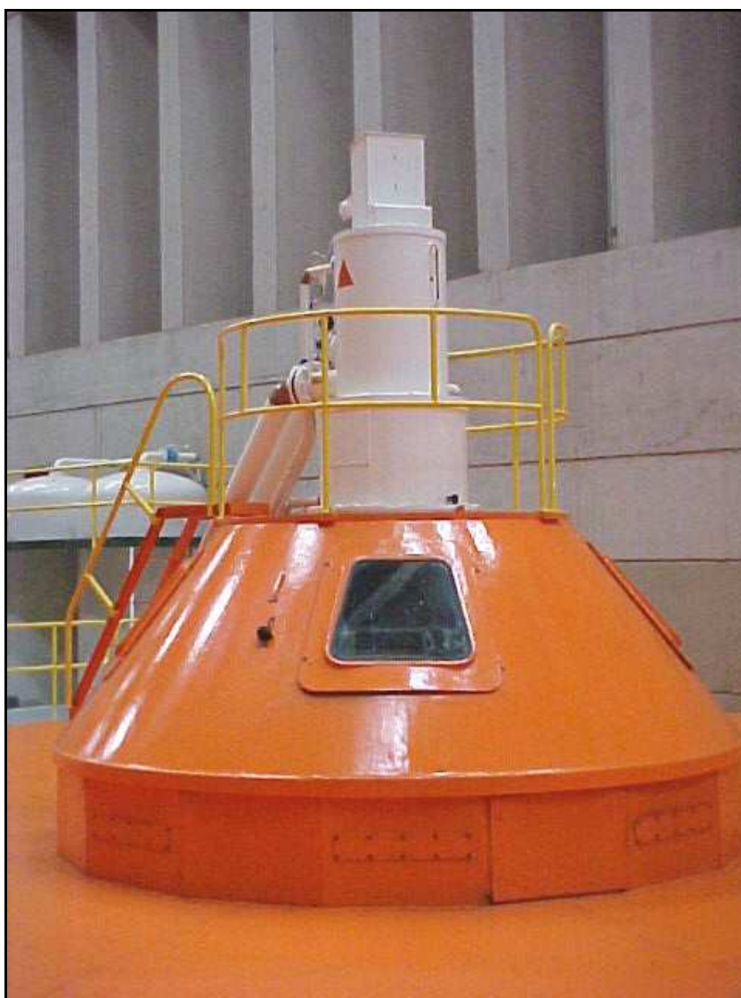
Foto 10 – Vista de um dos geradores (FONTE: MRS).
