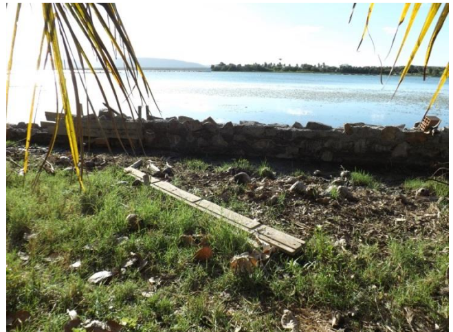
Foto 65. Barreiras contra escoamento do solo, construída pelo empreendedor, na margem do lago
