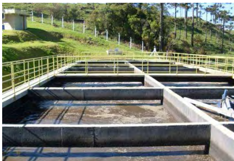
Ilustração 6-861. Tanque de Aeração da CASAN em São Joaquim.
