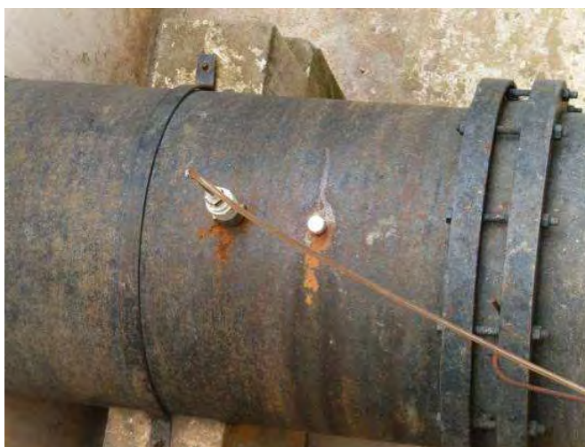
Ilustração 6-852. Tubulação de bombeamento na chegada à ETA.
