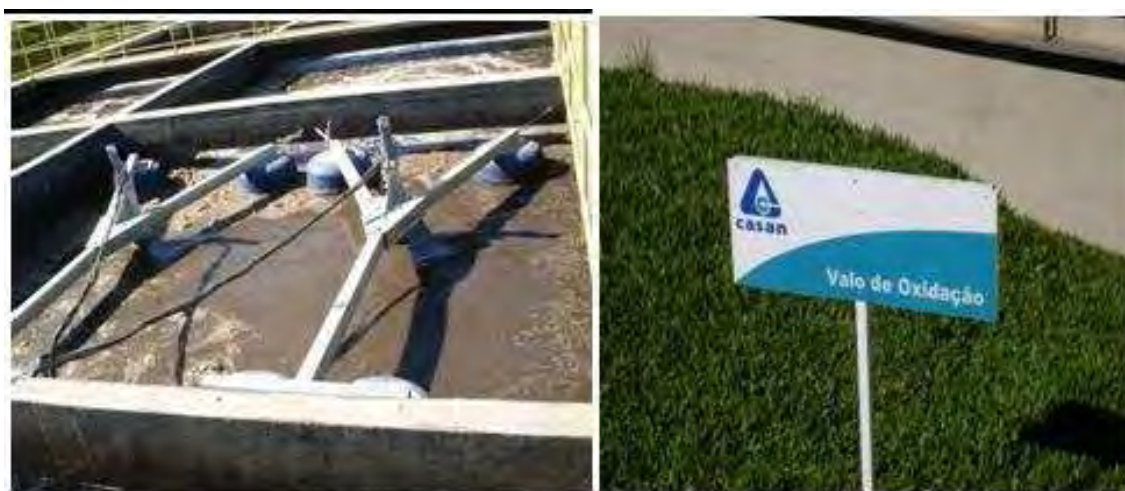
Ilustração 6-860. ETA – Equipamentos de aeração no Valo de Oxidação do sistema de esgoto.
