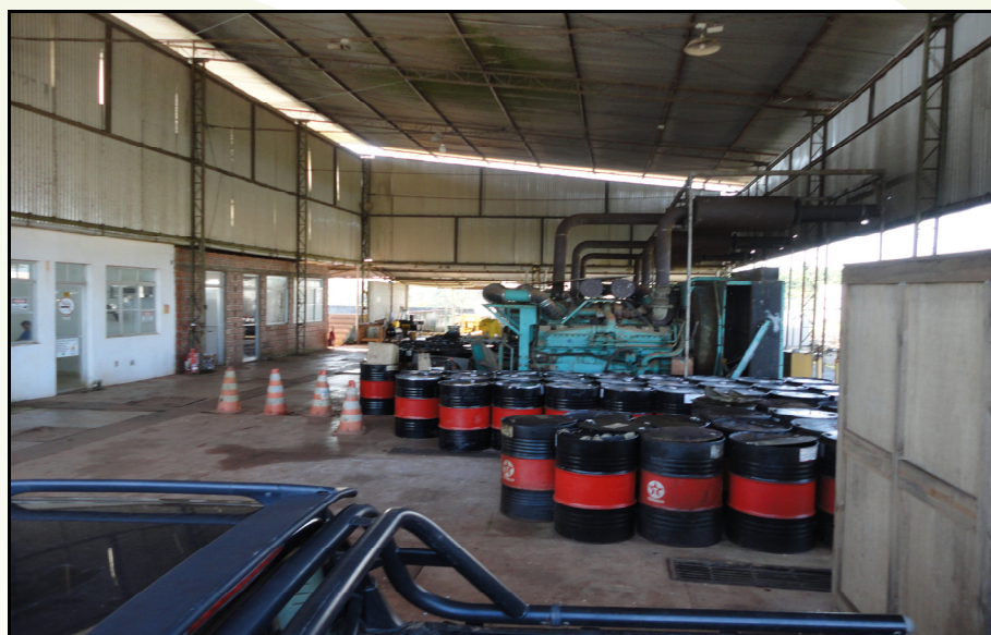
Foto 2 - Vista parcial do interior da usina térmica de Oiapoque, localizada no entorno da sede urbana do mesmo município. Podem ser observados ao fundo os geradores, tendo em primeiro plano, inúmeros barris de óleo diesel destinados aos equipamentos.
