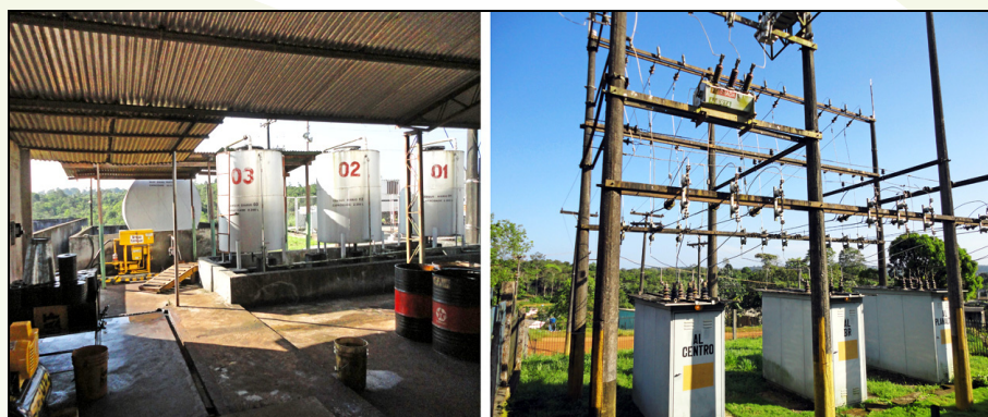
Foto 17 - Tomada da unidade de geração de Oiapoque, onde podem ser vistos os tanques de óleo na fotografia à esquerda. Na foto da direita, detalhe da pequena subestação de distribuição do município.
