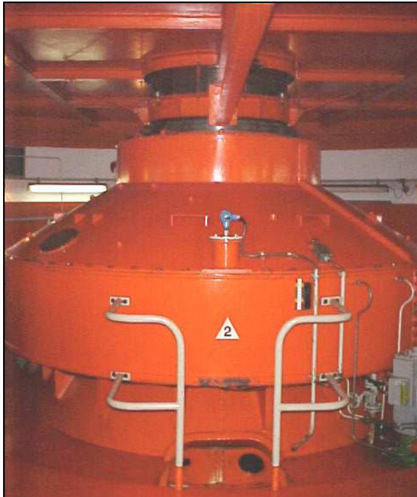
Foto 9 – Vista do eixo da turbina da UHE Marimbondo (FONTE: MRS).
