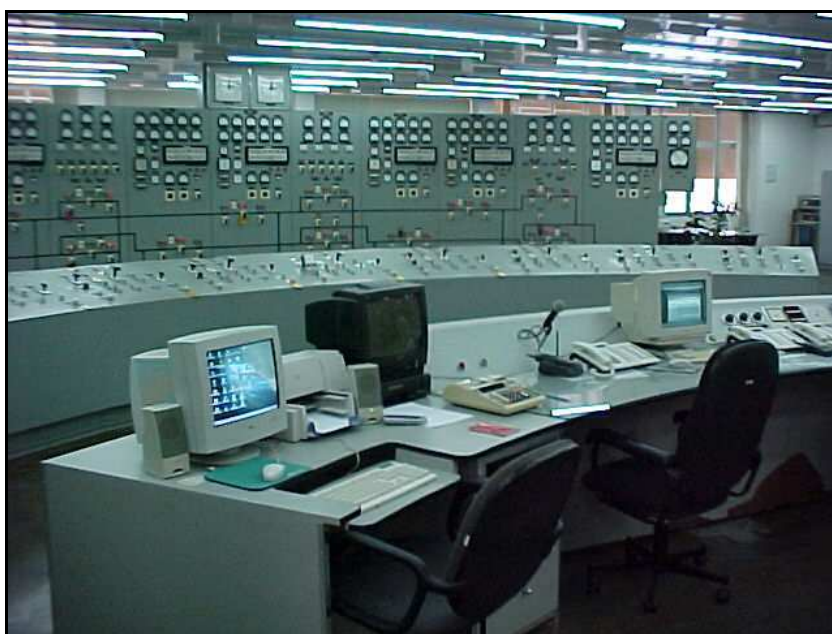
Foto 8 – Vista da Sala de Controle da UHE Marimbondo (FONTE: MRS).
