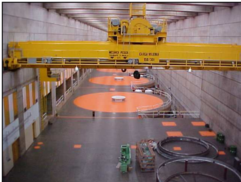
Foto 10 – Vista da área de serviço e plataforma dos geradores com a ponte rolante no detalhe (FONTE: MRS).
