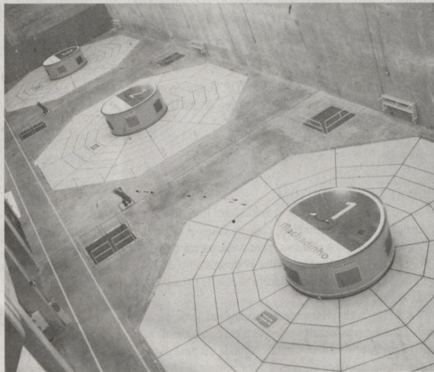
Geradores de energia da Usina Hidrelétrica Machadinho
