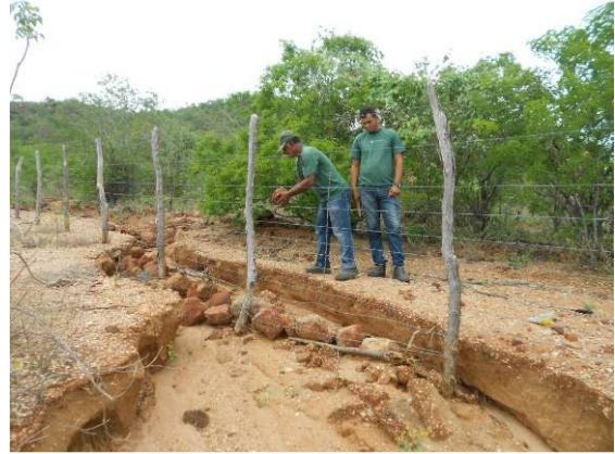
Img. 353 – Utilização de rochas para redução da velocidade da correnteza que provoca erosões e danificam a cerca da área 5. (Petcon 2014)
