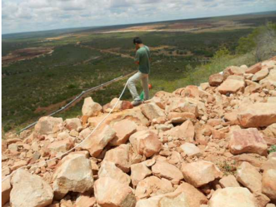
Img. 107 – Área íngreme com predominância de rochas soltas no talude (Fevereiro 2014)
