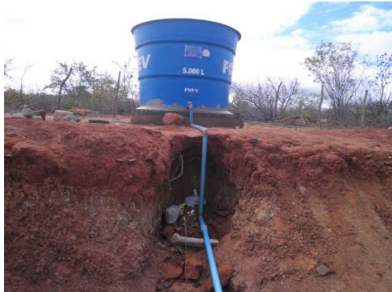
Img. 42 – Reservatório e conexões instalados na área 03. (Agosto/2012).
