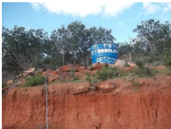
Img. 44 – Reservatório instalado na área 05 (Outubro, 2012)
