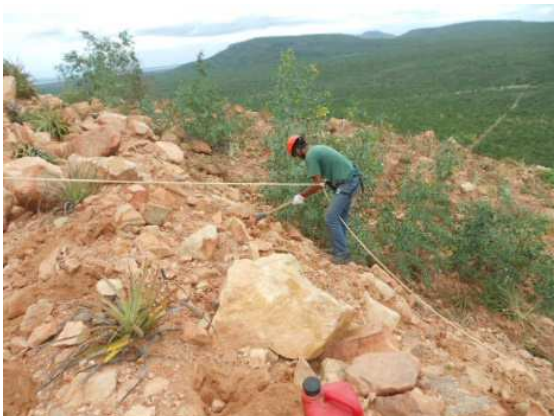
Img. 111– Excesso de rochas dificulta o trabalho de coveamento no talude. (Fevereiro 2014)
