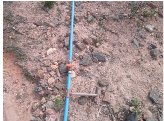
Img. 35 – Tubulação e acessórios hidráulicos. (Junho, 2012).
