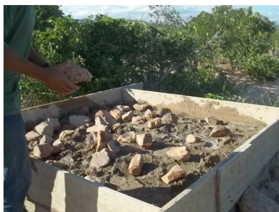
Img. 39 – Construção da base para apoio e nivelamento do reservatório na área 5. (Junho, 2012).
