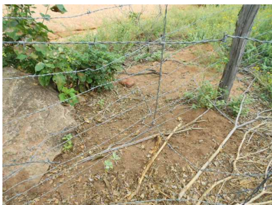
Img. 344 – Cerca danificada por moradores da região para facilitar a entrada de animais. (Petcon 2014)
