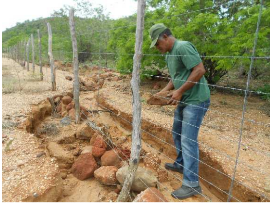
Img. 352 – As fortes chuvas incomuns nesta região provocaram vários processos erosivos na área 5. (Petcon 2014)
