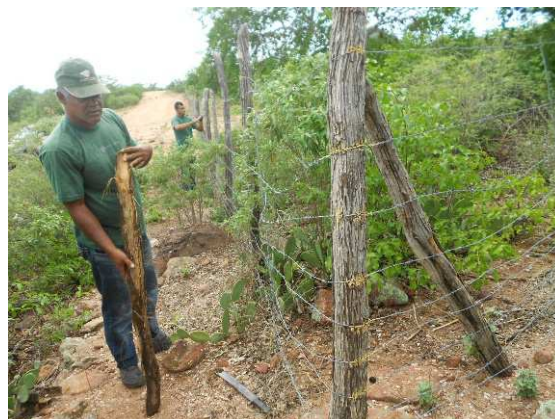
Img. 347 – Manutenção de cerca danificada por moradores locais. (Petcon 2014)
