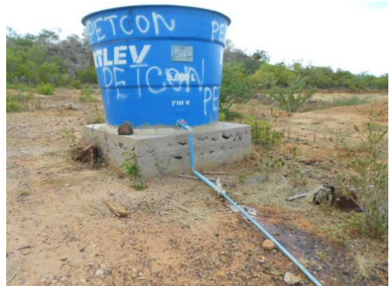
Img. 43 – Reservatório e conexões instalados na área 04. (Agosto/2012).
