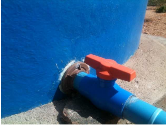
Img. 32 – Registro para abertura, fechamento e controle da vazão da água. (Julho, 2012).
