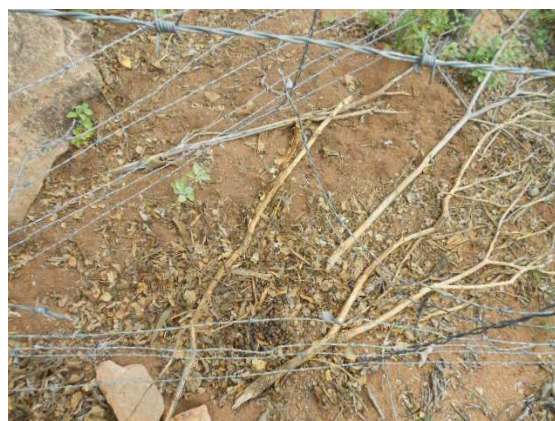
Img. 345 – Cerca danificada com indícios de entrada de animais (Petcon 2014)
