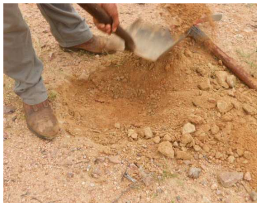
Img. 127 – Pouca camada de solo dificulta o coveamento. (Petcon 2014)
