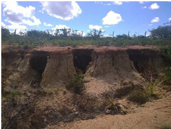
Img. 168 – Barranco na área 3 em estágio avançado de erosão. (Novembro, 2014).
