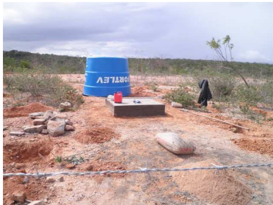
Img. 34 – Reservatório de fibra de vidro com capacidade para 5.000 litros. (Junho, 2012).
