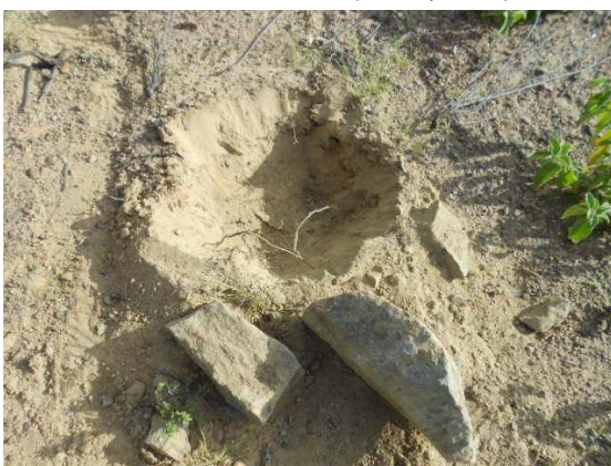
Img. 128 – Rocha encontrada durante abertura de covas, danifica ferramentas. (Petcon 2014)
