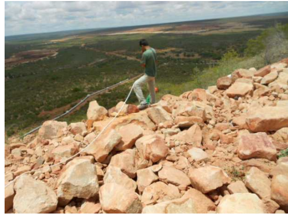
Img. 87 – Solo com predominância de rochas exposta e soltas na área de talude
