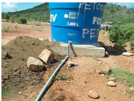
Img. 46 – Reservatório de fibra de vidro instalado na área 07 (Novembro, 2012)
