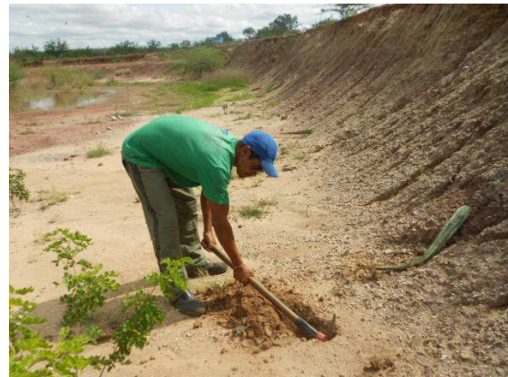
Img. 93 - Coveamento da área 3 para plantio de mudas de do tipo herbáceas (Maio 2014)
