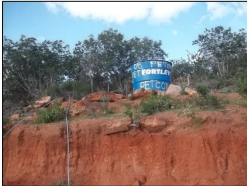
Figura 11 – Reservatório instalado na área 03 (PETCON, 2013)
