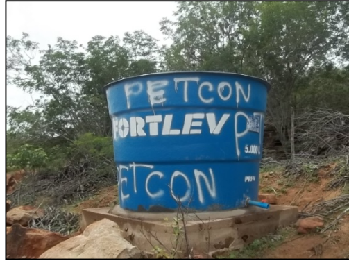
Figura 10 – Reservatório instalado na área 06 (PETCON, 2013)
