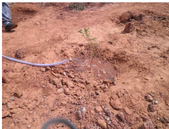
Foto 37 – Tubulação para irrigação. Silva, Elaine Cristina (Junho, 2012).
