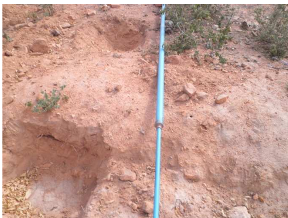
Foto 38 – Tubulação e acessórios hidráulicos. Silva, Elaine Cristina (Julho, 2012).
