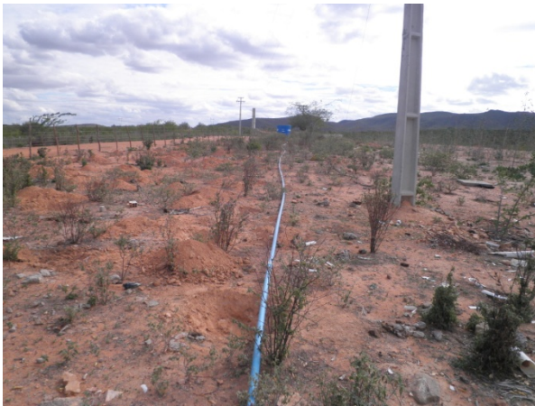
Foto 39 – Tubulação para irrigação. Silva, Elaine Cristina (Junho, 2012).
