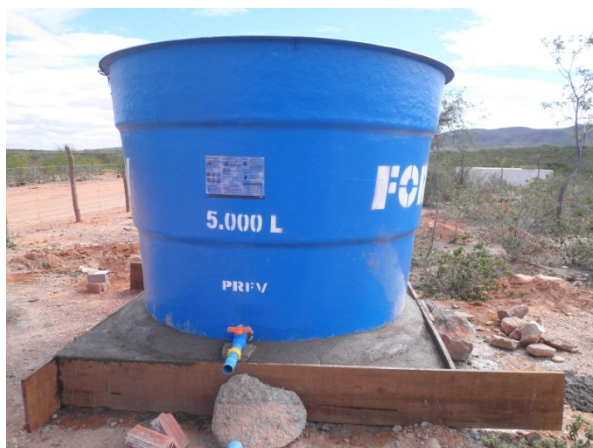
Foto 34 – Reservatório de fibra de vidro e acessórios hidráulicos. Silva, Elaine Cristina (Junho, 2012).
