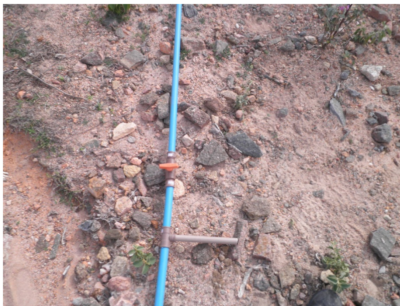
Foto 12 – Tubulação e acessórios hidráulicos. Silva, Elaine Cristina (Junho, 2012).
