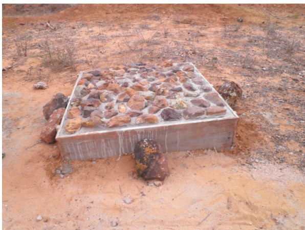
Foto 31 – Construção da base para apoio e nivelamento do reservatório. Silva, Elaine Cristina (Junho, 2012).
