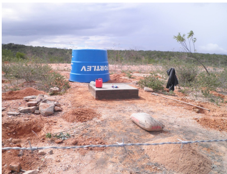
Foto11 – Reservatório de fibra de vidro com capacidade para 5.000 litros. Silva, Elaine Cristina (Junho, 2012).
