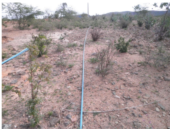
Foto 36 – Tubulação para irrigação. Silva, Elaine Cristina (Junho, 2012).
