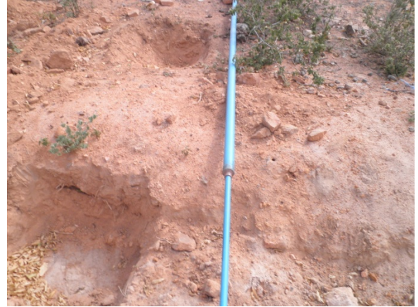
Foto 38 – Acessório hidráulico e tubulação. Silva, Elaine Cristina (Junho, 2012).
