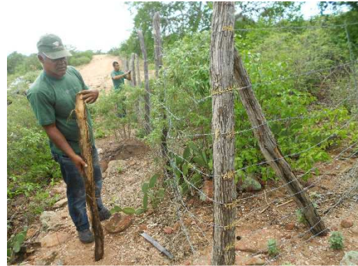
Fig. 45 – manutenção da cerca danificada pela chuva área 06.
