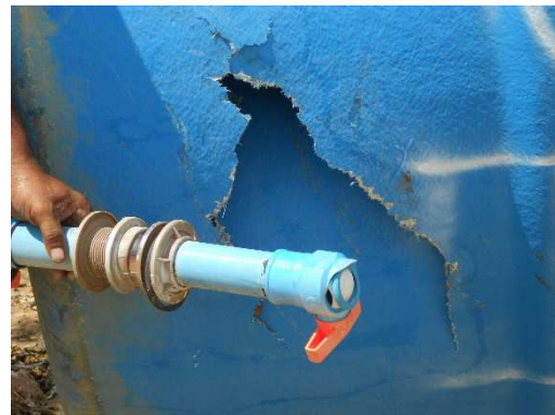
Fig. 35 - Durante a tentativa de furto a Caixa d'água foi danificada (Petcon 2014/15)
