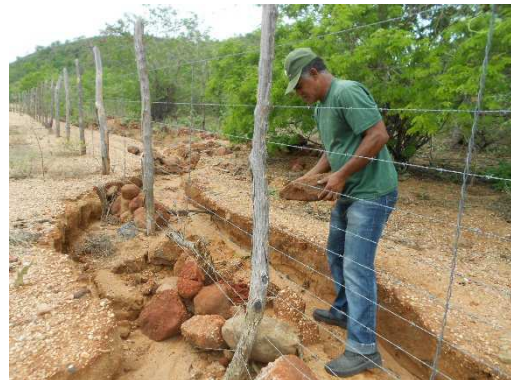
Fig. 41 – Fortes chuvas provocaram erosões que danificaram as cercas da área 5.
