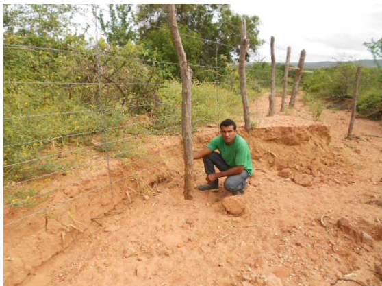
Fig. 20 – Cerca danificada pelo processo gradativo de erosão na área 05 (Petcon 2014)
