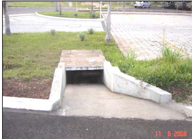
FIGURA 07 – Caixa de captação de águas pluviais da UHE Eng. Souza Dias (Jupiá)
