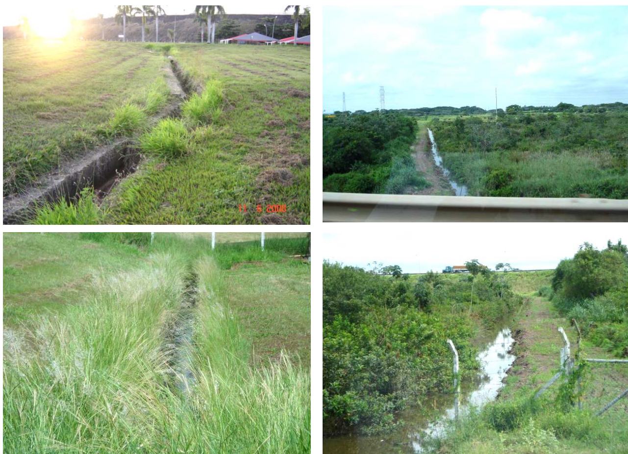
FIGURA 08 – Canaletas de águas pluviais com limpeza na UHE Eng. Souza Dias (Jupiá)
