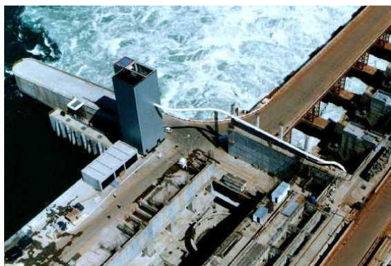
Figura 10. Vista geral do elevador para peixes da UHE Engenheiro Sergio Motta.
