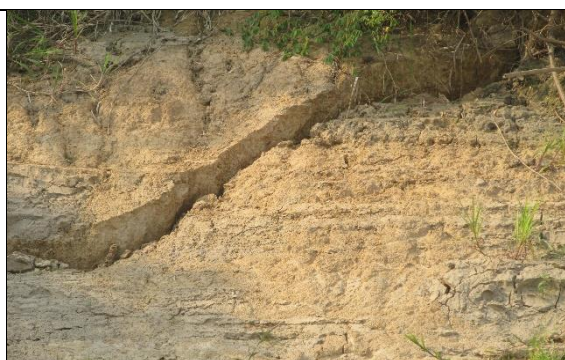
Figura 15 - Foto de detalhe da ruptura de solo provocada pelo aumento de carga devido ao rebaixamento do nível do rio.
