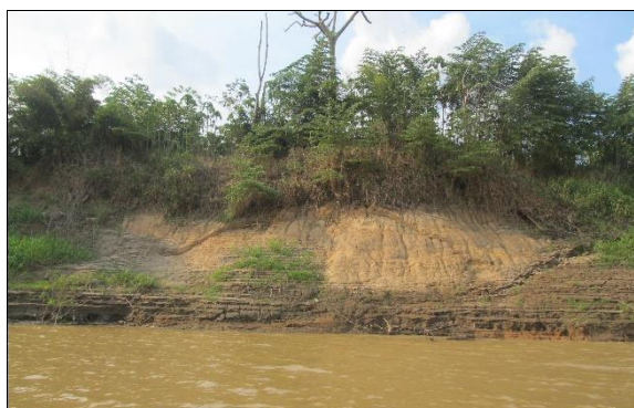
Figura 14 - Foto mostrando exposição de processo do tipo "terras caídas", na porção inferior do talude, e ruptura de solo na porção média do talude, provocada pelo rápido rebaixamento do rio.
