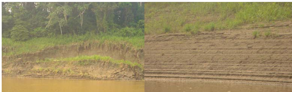
Figura 4 – Fotografias mostrando as margens do rio madeira com processos de instabilização de encostas e erosão nos depósitos aluvionares.
