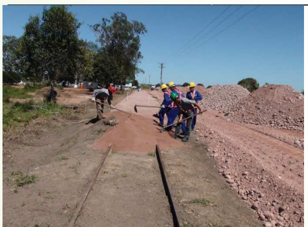
Foto 3 – Cobertura com sedimento fino
