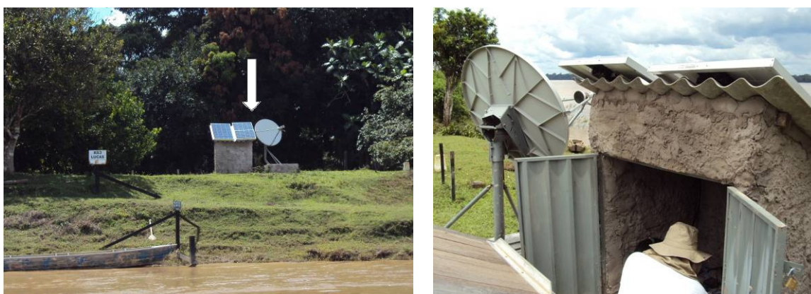
Figura 50. Painéis solares, antena de transmissão e abrigo de alvenaria do sistema de monitoramento em tempo real instalados na proximidade da margem do rio Madeira (RS 3 - Lucas).
