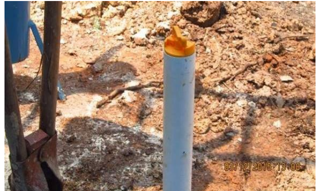
Foto 4-4 – Detalhe do “cap” de pressão, utilizado para vedar o piezômetro.
