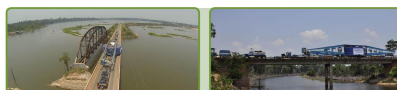
Para garantir ainda mais a segurança, a ESBR reforçou a estrutura das pontes de Jaci-Paraná e do Rio Caracá na BR-364
