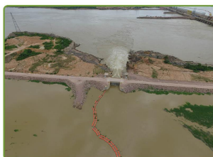
A construção do sistema foi concluída em 2013 e funciona basicamente no período chuvoso, quando aumenta o nível do rio Madeira
