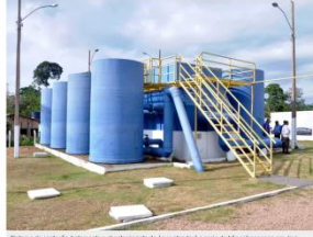
Sistema de captação, tratamento e abastecimento de água atendendo a mais de 150 mil pessoas em Jaci-Paraná, distrito de Porto Velho, RO (Foto: ComunidadeEspajoko)
