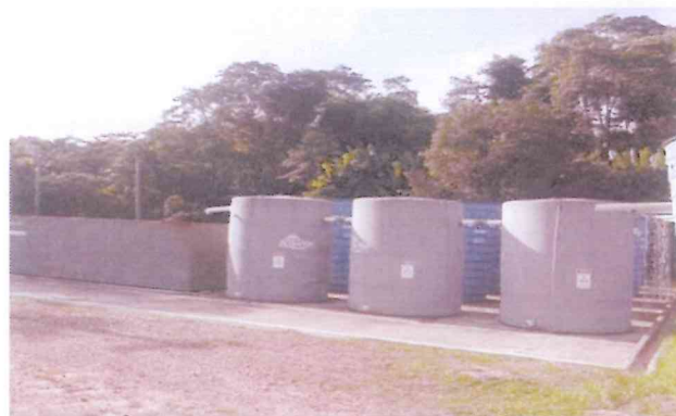
Figura 2-6 - Vista dos módulos de tratamento – ETE "C".
