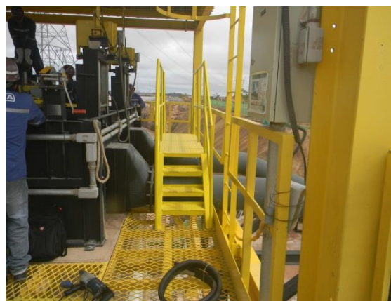
Figura 4.4.4. Realização de ajustes nas comportas dos tanques de triagem, assim como a instalação de escadas de segurança.
