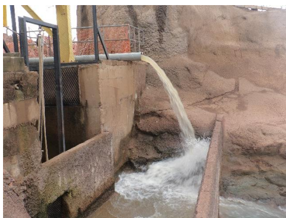
Figura 4.4.5. Instalação de tubulação para bombeamento de água diretamente para o canal condutor de peixes.
