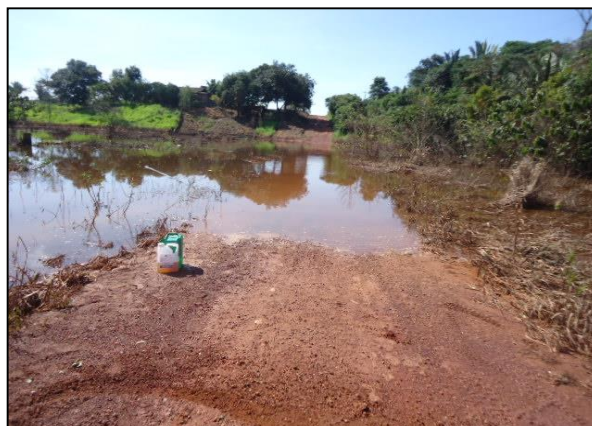
FOTO 02- Acesso interrompido na Linha F. em 07/04/2014
