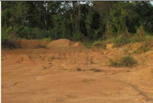
Foto 3 – Erosão laminar e sulcos erosivos superficiais em via de acesso à Área de Empréstimo.
