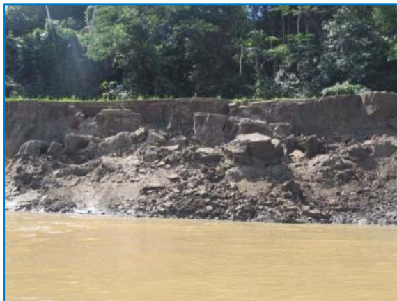
Figura 4-1 - Colapso de solo na margem direita do rio Madeira - depósito fluvial recente inconsolidado.
