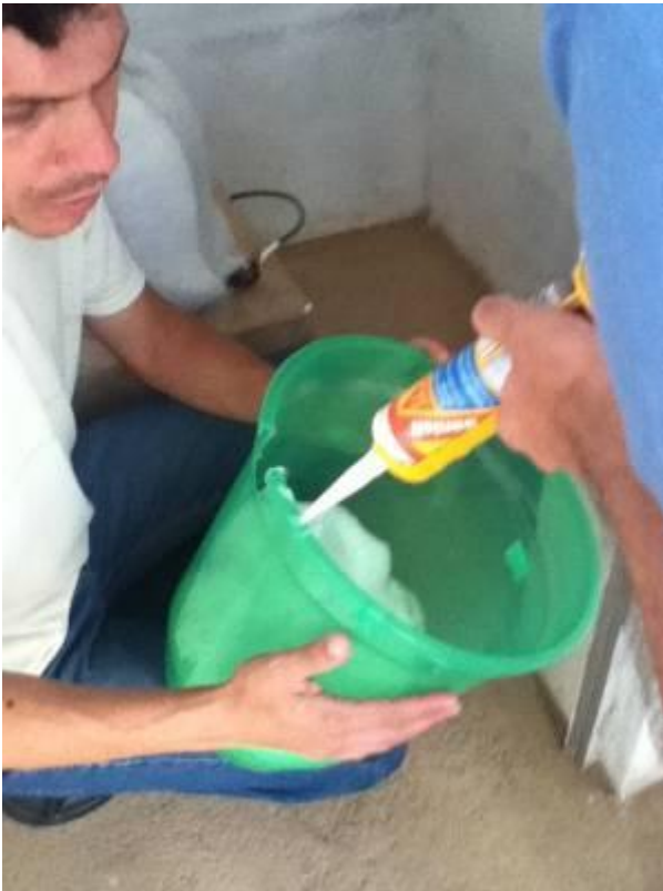
Foto 16 – O balde será fixado ao redor do sensor, para garantir um melhor isolamento.
