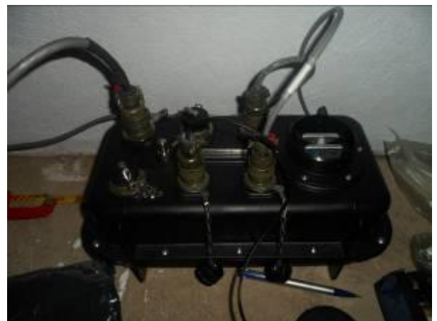
Foto 17 – Registrador instalado na prateleira da Sala do Registrador, com todas as suas conexões plugadas: cabo do sensor, cabo da bateria e cabo do GPS.
