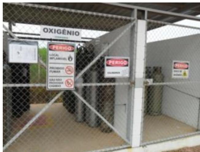
Imagem 08- Depósito de Gases Inflamáveis
