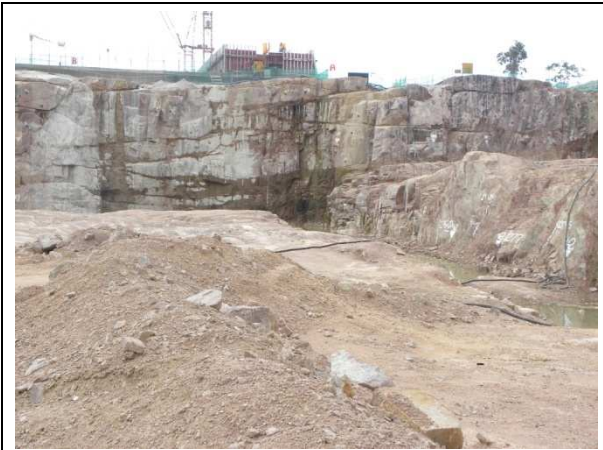
Figura 10 – Casa de força – margem esquerda (24/11/2010)
