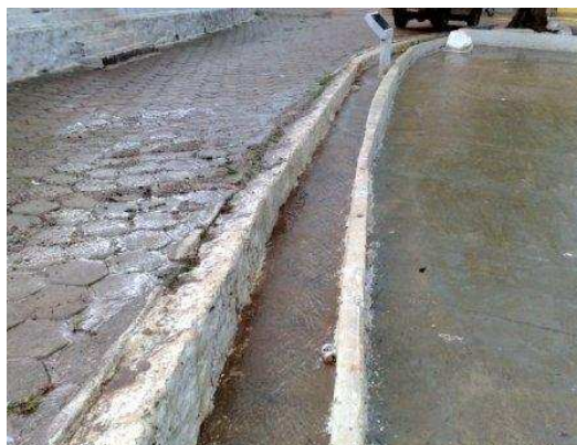
Foto 154 - Galeria de água que necessita ser tampada
