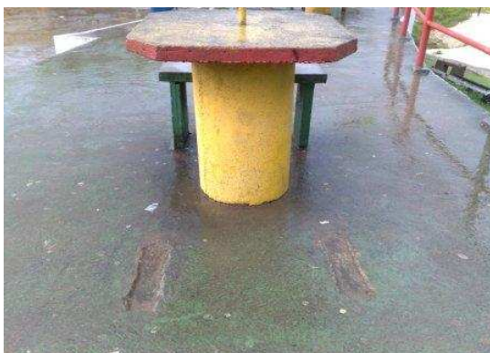
Foto 155- Banco que necessita ser recolocado
