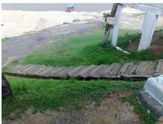
Foto 157 - Escadaria de acesso á praia que deverá ser recuperada
