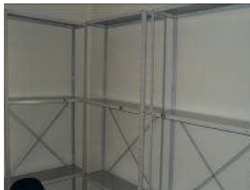
Foto 43 - Farmácia, armários de aço
