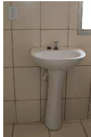
Foto 33 - Detalhe de pia da sala de procedimento
