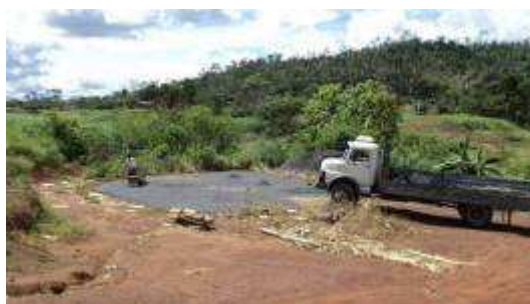
Foto 113 - Ponto SM3 – Pátio de secagem de minério lavado.
