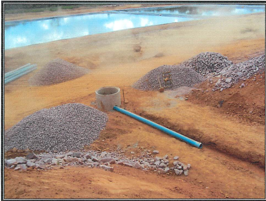
Figura 4- Vista da chegada do tubo coletor de chorume a caixa de passagem.
