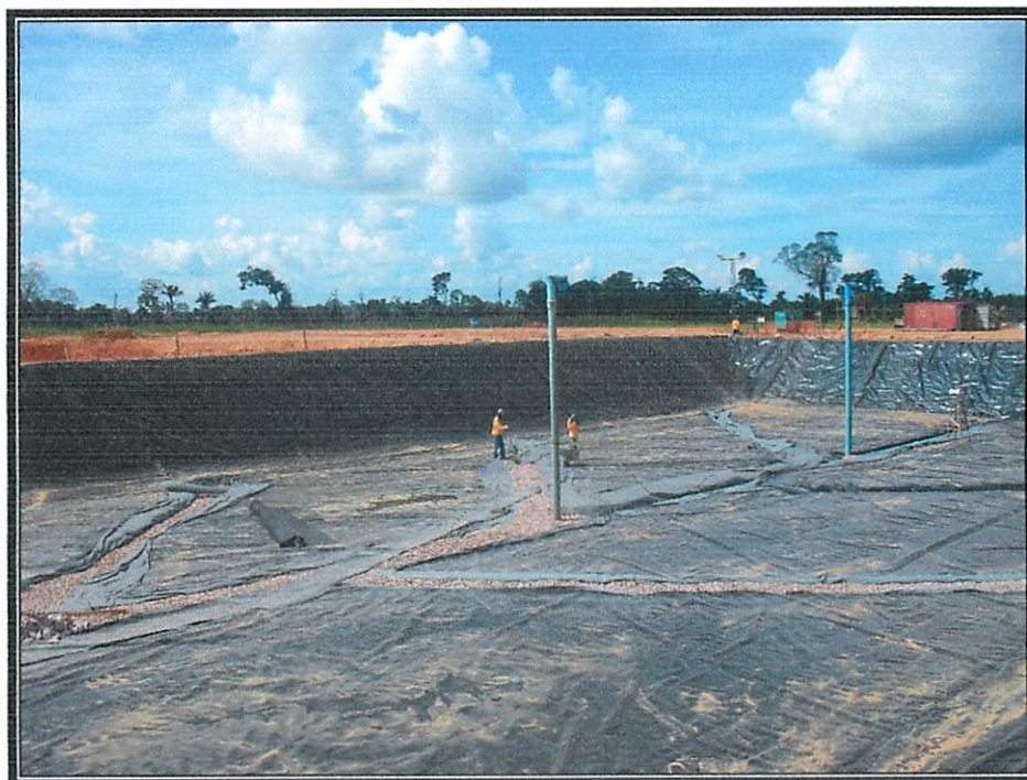
Figura 3- Execução da drenagem de fundação: Geotextil + brita + tubo de dreno + brita + transpasse do geotextil.
