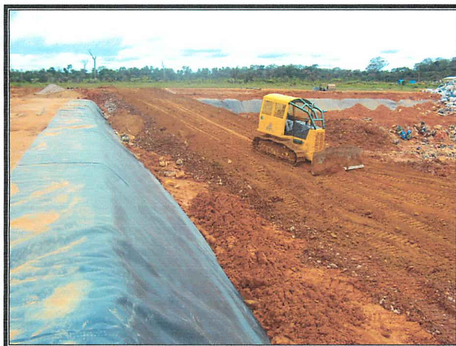
Figura 15- Melhoria dos acessos internos em decorrência dos problemas relacionados à chuva.
