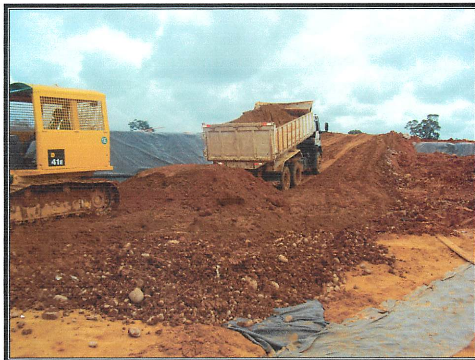
Figura 14- Melhoria dos acessos internos em decorrência dos problemas relacionados à chuva.
