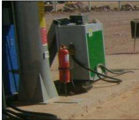
Imagem 57 – Bomba de combustível
