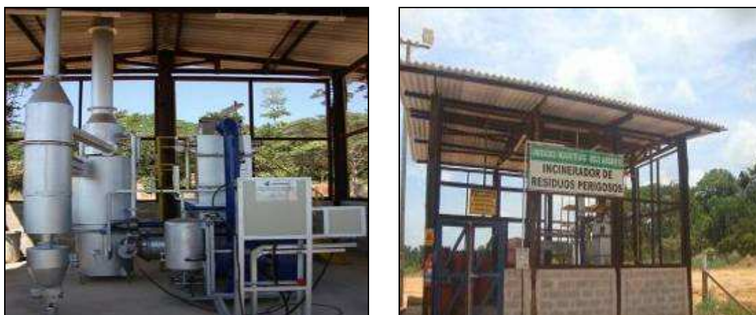
Imagem 42 – Incinerador instalado no Canteiro de Obras
