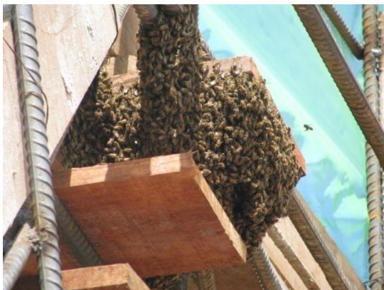
Vista geral do enxame de Apis mellifera em forma de cacho, alojado entre degraus no vertedouro.
