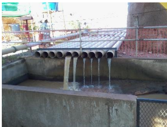
Figura 4. Vazão reduzida das bombas de recalque em funcionamento no STP-1 em função do acúmulo de sedimentos no local de captação da água.
