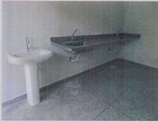
Figura 64: Interior de um recinto de quarentena. CETAS da UHE Santo Antônio.
