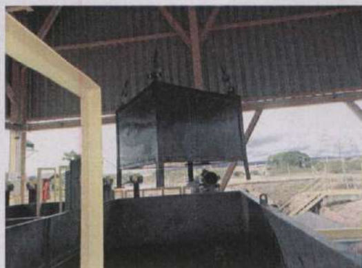
Figura 33: Operação do STP de Jirau da margem direita.
