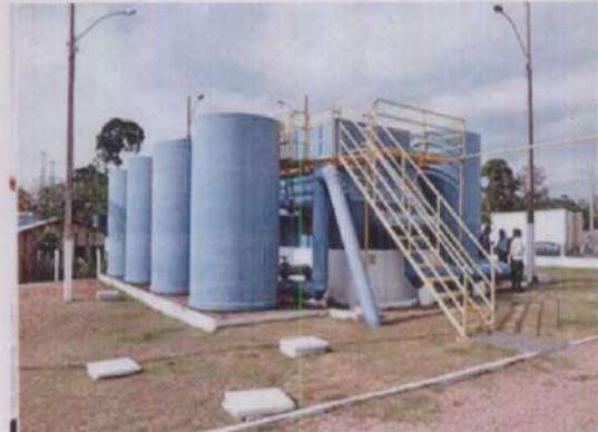
Foto 04 – Sistema de Abastecimento de água Jaci Paraná.
