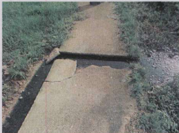
Figura 27: Esgoto a céu aberto nas Ruas de Nova Mutum Paraná-RO.
