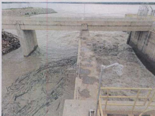
Figura 15: Sistema de Transposição de Troncos da UHE de Santo Antônio, lado a jusante.
