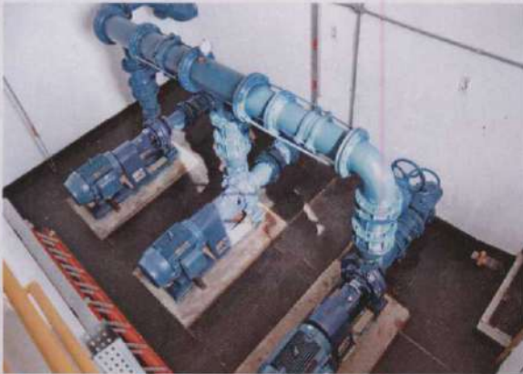
Foto 09 – Sistema de Abastecimento de água.
