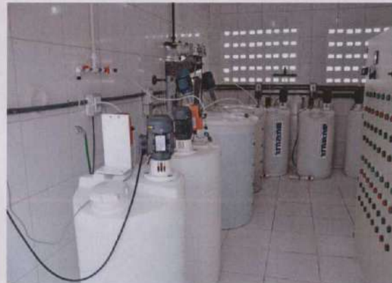
Foto 10 – Sistema de Abastecimento de água.
