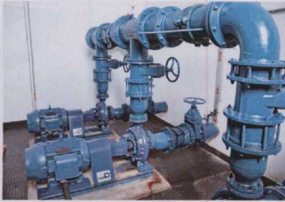
Foto 07 – Sistema de Abastecimento de água.
