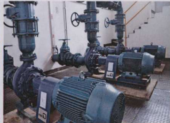
Foto 08 – Sistema de Abastecimento de água.
