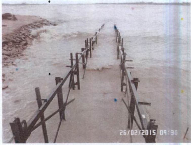
Foto 2 – Situação do STP metálico em 26 de fevereiro de 2015.
