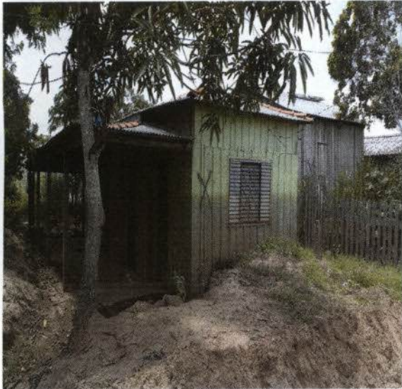
Foto 5: Casas condenadas pela Defesa Civil após cheia de 2014, próximas ao barranco, bairro CCO.
