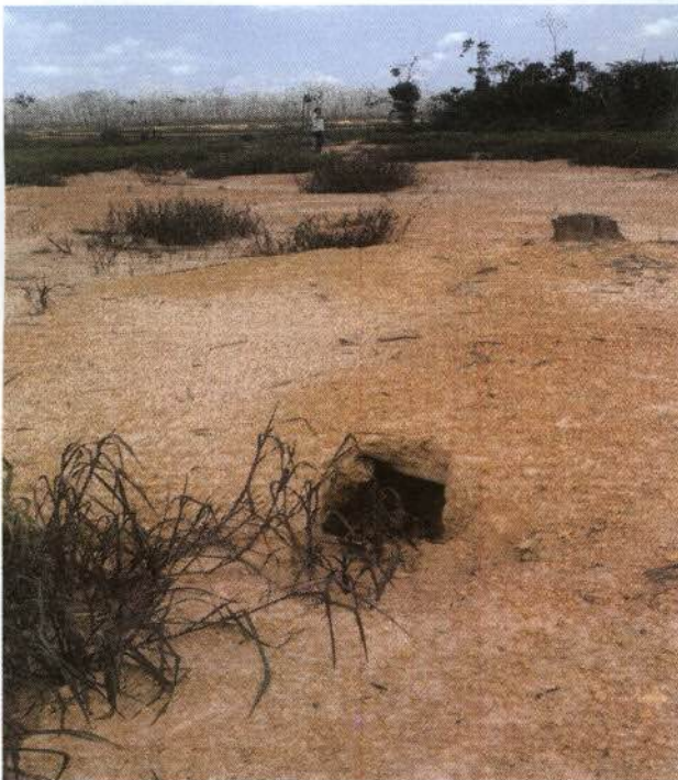
Foto 9: Vala de enterrio de material de desmatamento aflorando material lenhoso.
