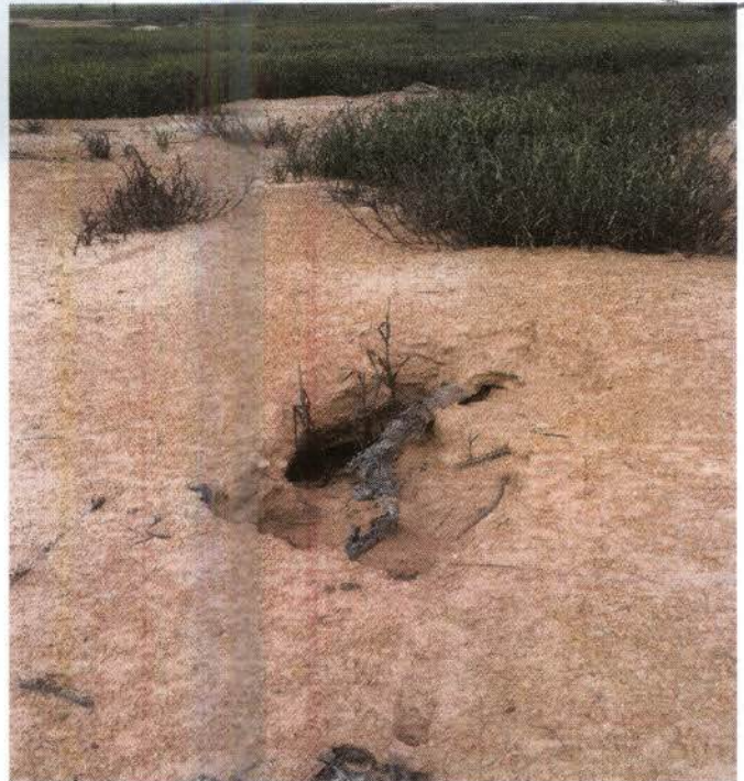
Foto 10: Material lenhoso aflorando após reabertura de vala devido à compactação inadequada do terreno, que está cedendo.
