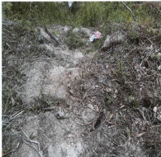
Foto 7: Rachaduras no barranco do Porto do Alceu (Ponto 2).
