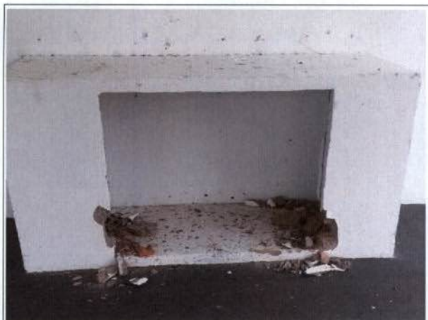
Foto 05 – Abrigo de gás danificado.
