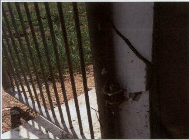
Foto 07 – Porta da casa de força danificada
