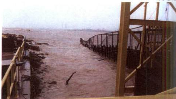
Foto 2 - Níveis d'água no STP metálico.
