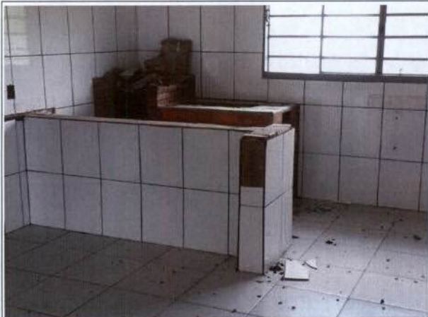
Foto 09 – Parede do balcão danificada
