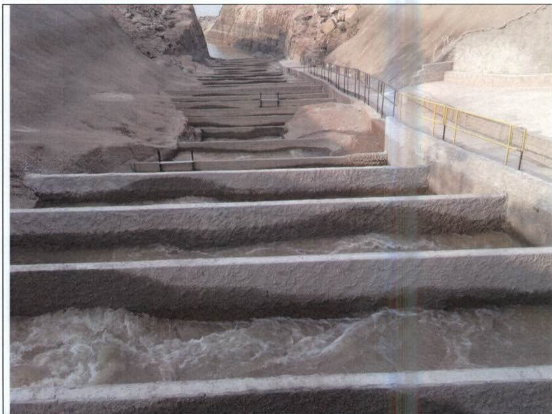
Foto 1: Canal de atração reparado e melhorias em sua lateral – vista superior
