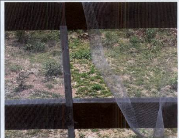
Foto 10 – Tela de proteção contra insetos rasgada
