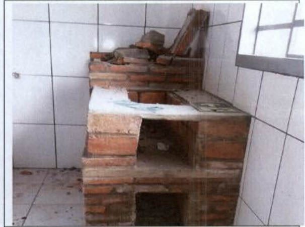
Foto 08 – Fogão a lenha parcialmente destruído
