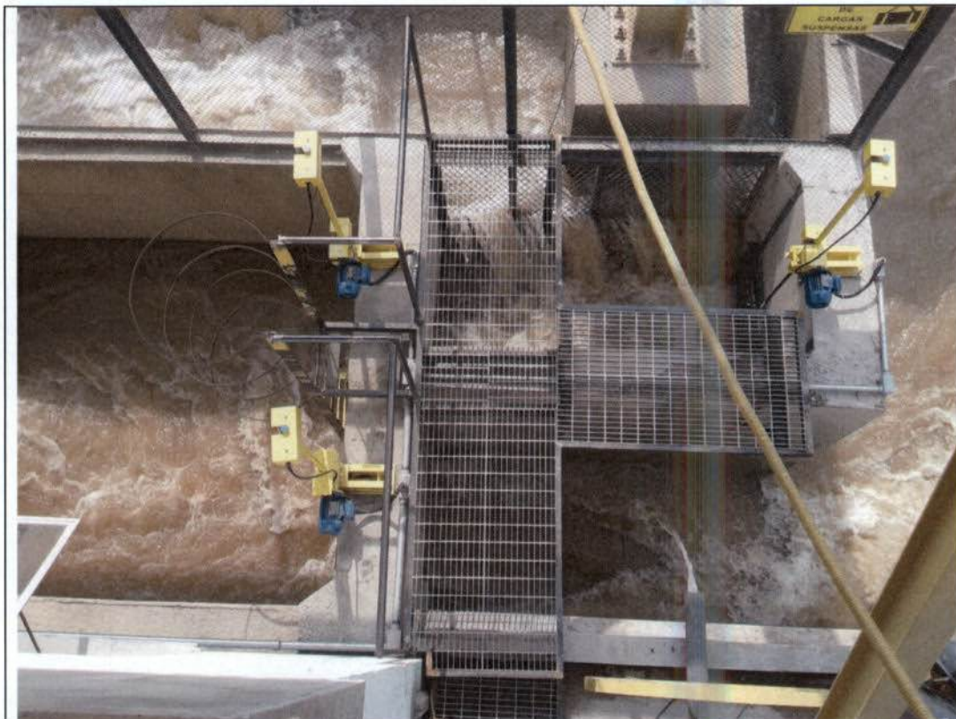
Foto 3: Tanque de acumulação em funcionamento
