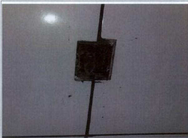
Foto 19 – Fiação das tomadas
